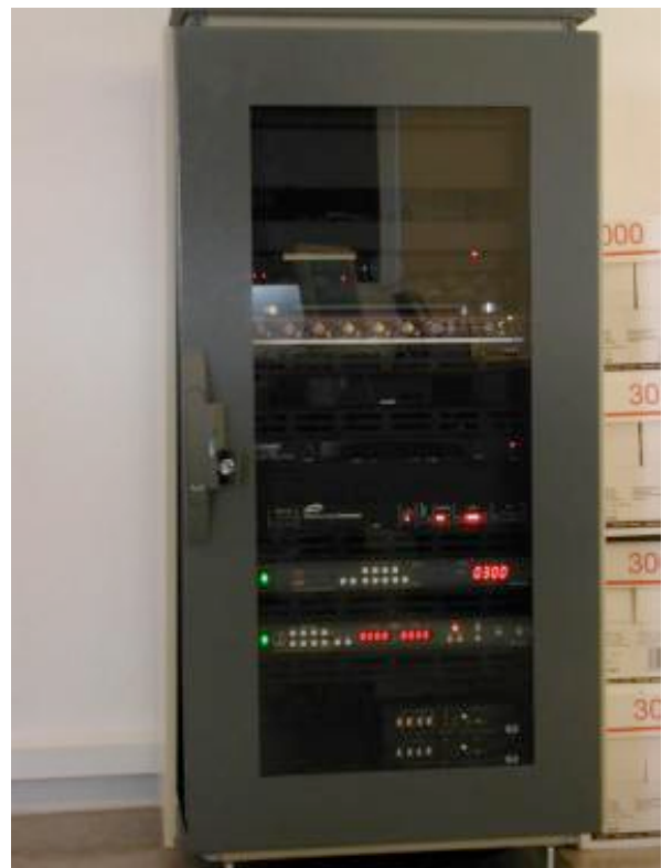
« 1. Vue de la baie technique »
